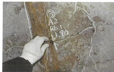
頂版下面のひびわれ（幅1.9mm）
