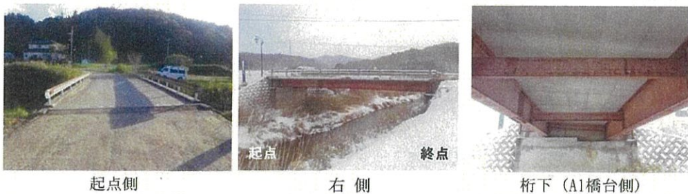
18. 文造橋: 鋼桁橋, 橋長: 16.46m, 1969年竣工 (55年経過) 2級村道草野関沢線、管理区分 [B]、判定区分 [II]・健全度ランク [C (3)]
