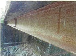
手鞍橋：主桁の腐食
