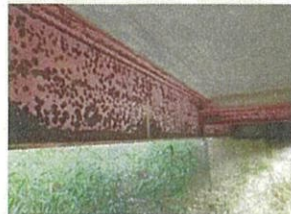
風兼橋：主桁の腐食
