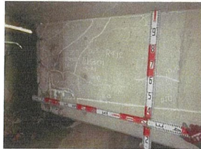
主桁端部の遊離石灰を伴うひびわれ
